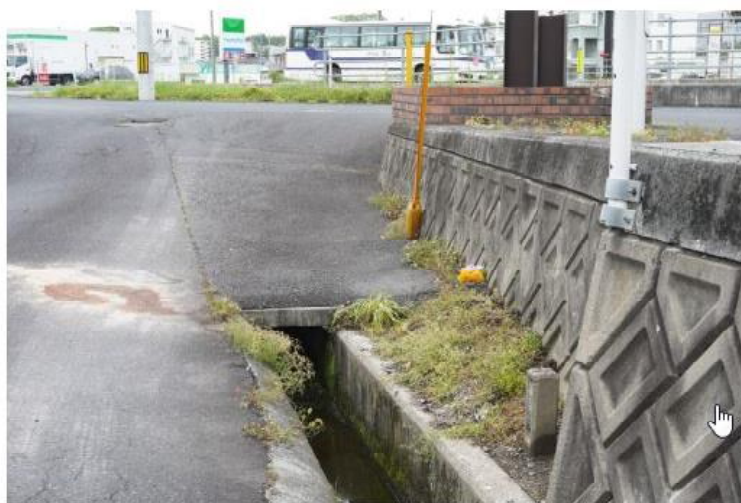
男性が転落した現場
